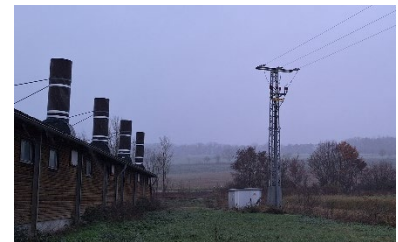
Anlagen der Bayernwerk Netz GmbH [VMB AG, 12/23]
